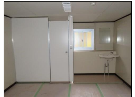
男女各更衣室に設置された洋式トイレと水道
